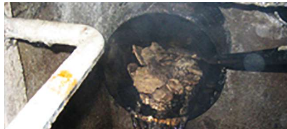
«Voici un bel exemple d'un bouchon dans une canalisation»
